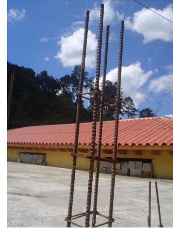
Armadura expuesta sin protección
